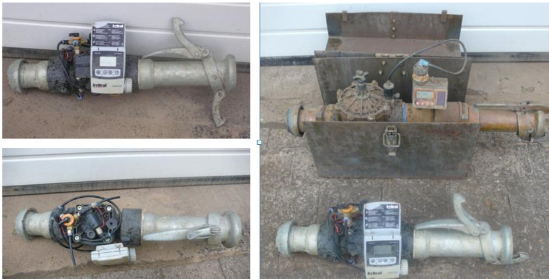
Abbildung 28: Oben rechts: altes Magnetventil mit Zeitschaltuhr, unten und links: neues Magnetventil mit Zeitschaltuhr
